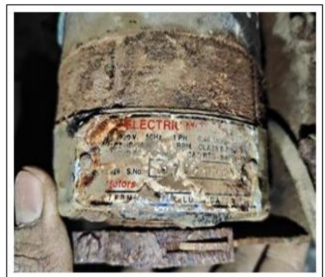
Fig 3 Damaged Fan Motor
